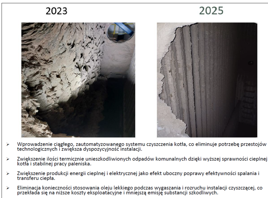
Rys. 5. Porównanie zanieczyszczeń przegrzewacza SH3 przed montażem urządzenia i realizacji inwestycji
