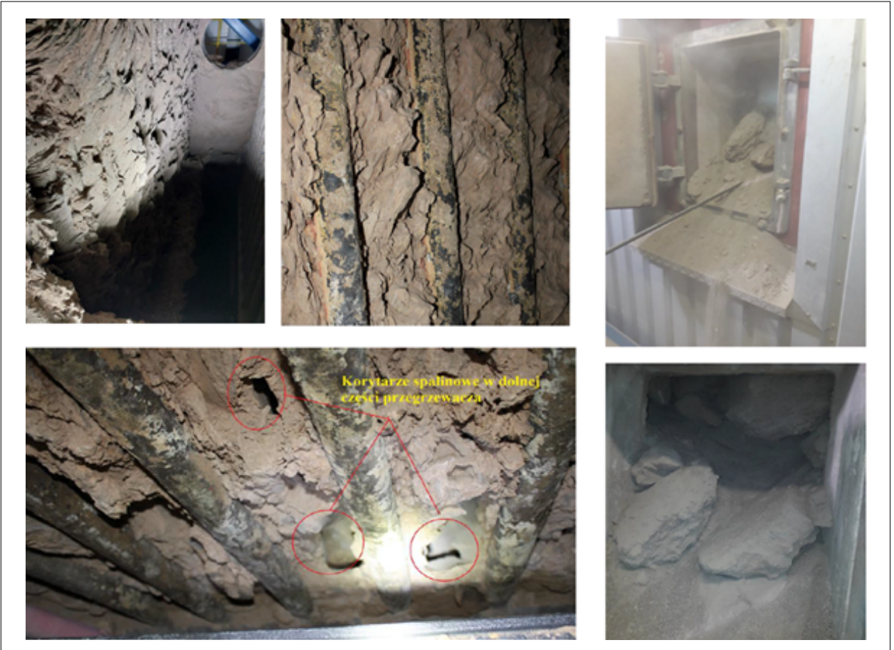
Rys. 4. Zanieczyszczenie części ogrzewalnych kotła przed wprowadzeniem generatorów uderzeń SPGr
