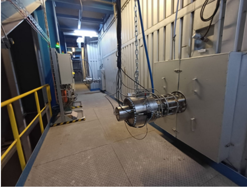
Rys. 3. Generatory uderzeń SPGr
