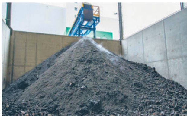
Bunkier żużla instalacji waloryzacji żużla
