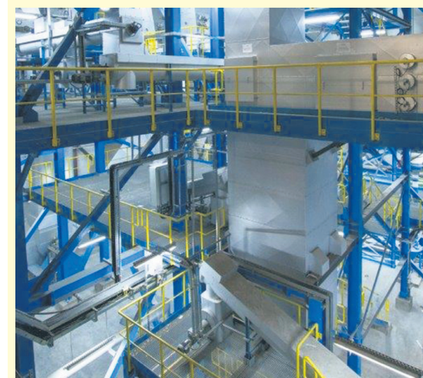
ZTUOK – hala oczyszczania spalin
