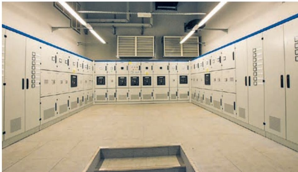
■ Rozdzielnia – mózg Spalarni
